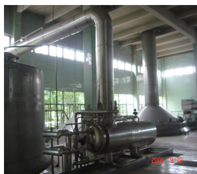
二期真空冷凝器
